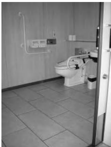
車いす対応トイレ
